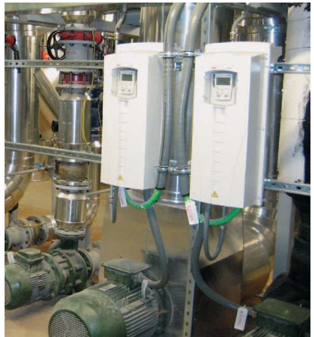
Applicazione tipica di pompe azionate mediante inverter.
