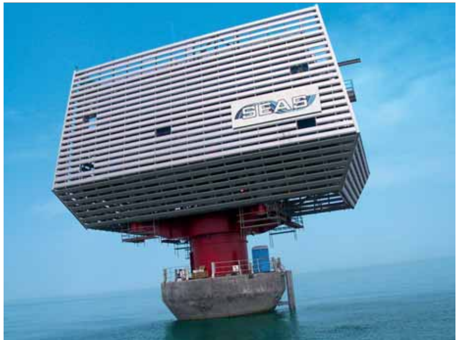
2 Trafostation für den Zusammenschluss der 72 Anlagen des Parks
