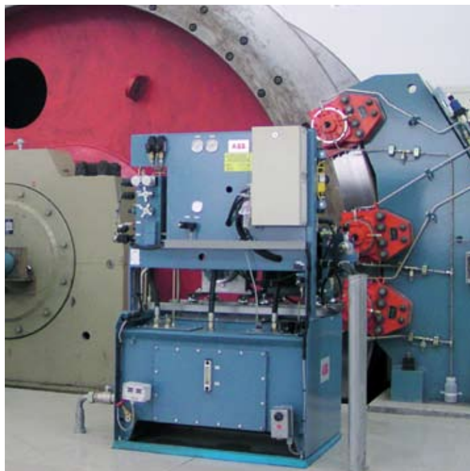
Samostatný brzdový systém ABB při uvádění do provozu na těžním stroji, který nepochází od ABB
