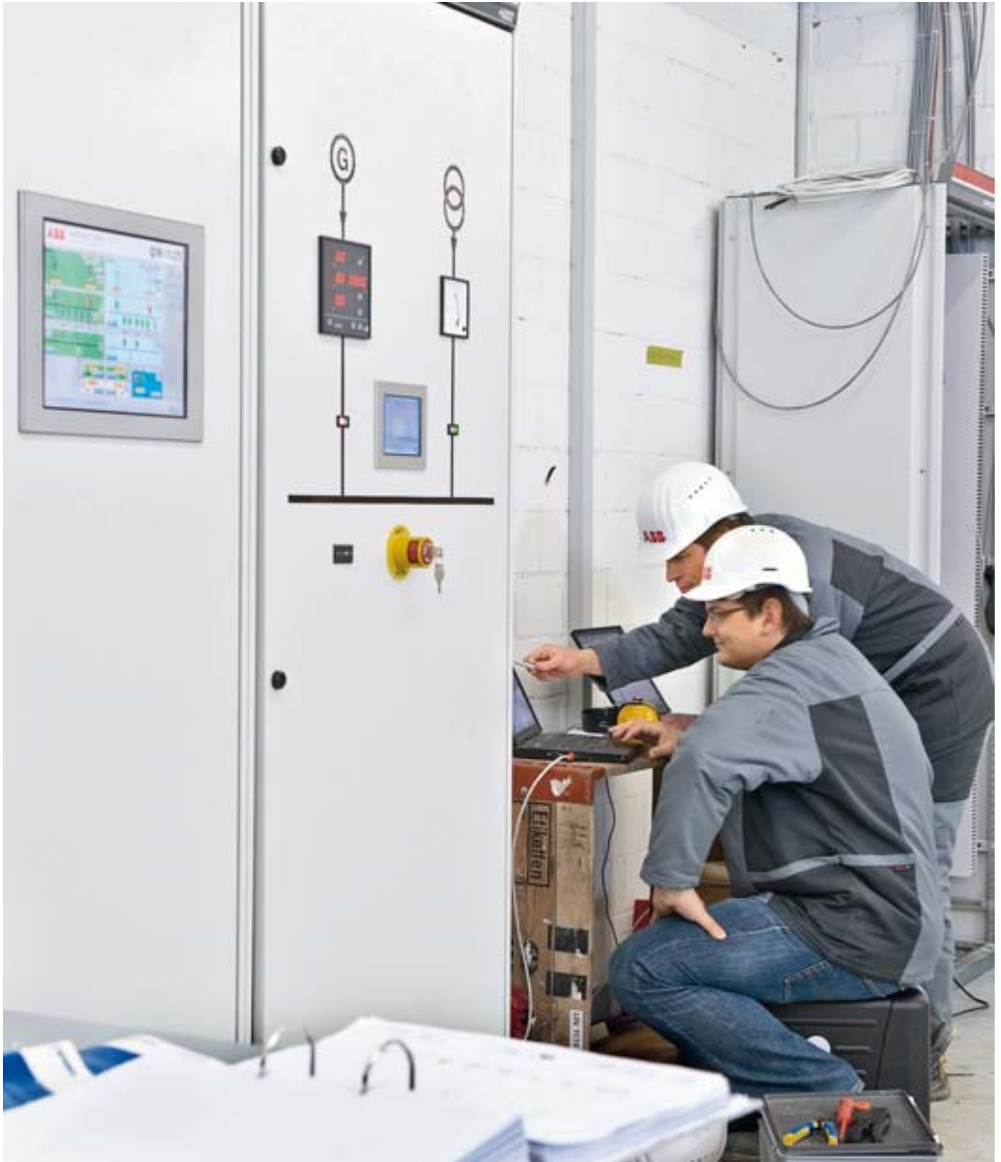
Spezialisten von ABB richten die Steuerung der Notversorgung ein.
