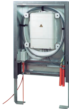
Kabelskab til bredbånd
