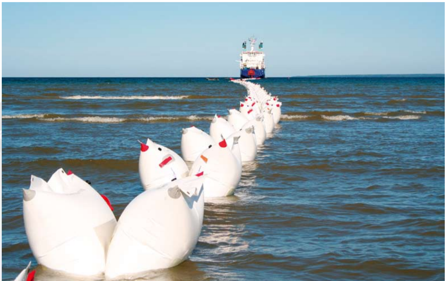
Het aan land brengen van de HVDC Light® kabel van de Estlink.
