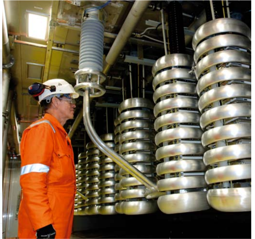
De kerncomponenten van HVDC Light ® zijn de halfgeleiderventielen die bestaan uit miljoenen vermogens-halfgeleiders. De uit IGBT's opgebouwde halfgeleiderzuilen zijn opgehangen aan het plafond van een zeer compacte converter-module die kant en klaar in de fabriek geproduceerd wordt.
