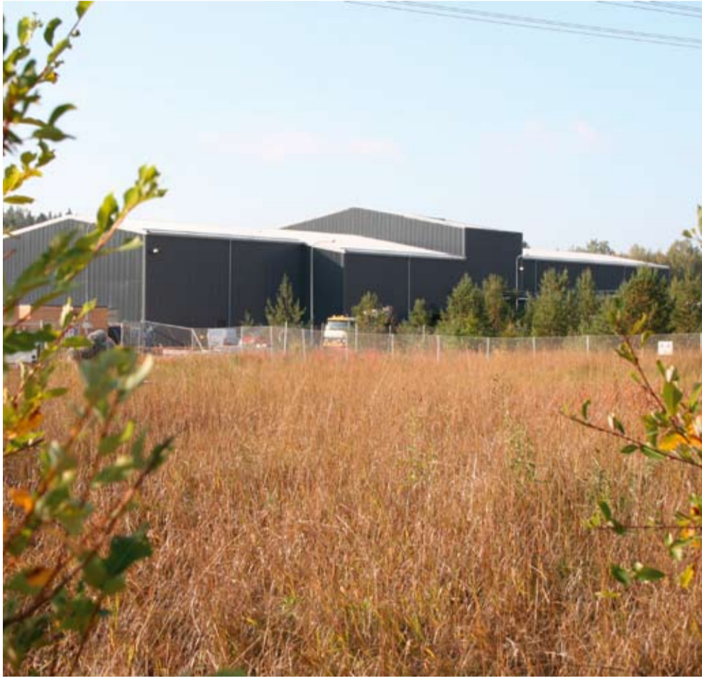
Het compacte HVDC Light ® compact converter aan de Finse zijde van de Estlink-verbinding in Esboö.
