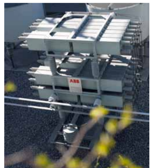
Condensatorbatterij van een SVC Light-installatie.
