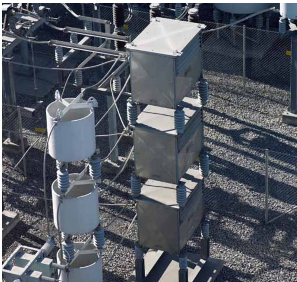
Smoorspoelen en dempingsweerstand van een SVC Light-installatie.
