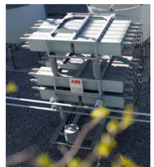
Batterie de condensateurs d'une installation SVC Light.
