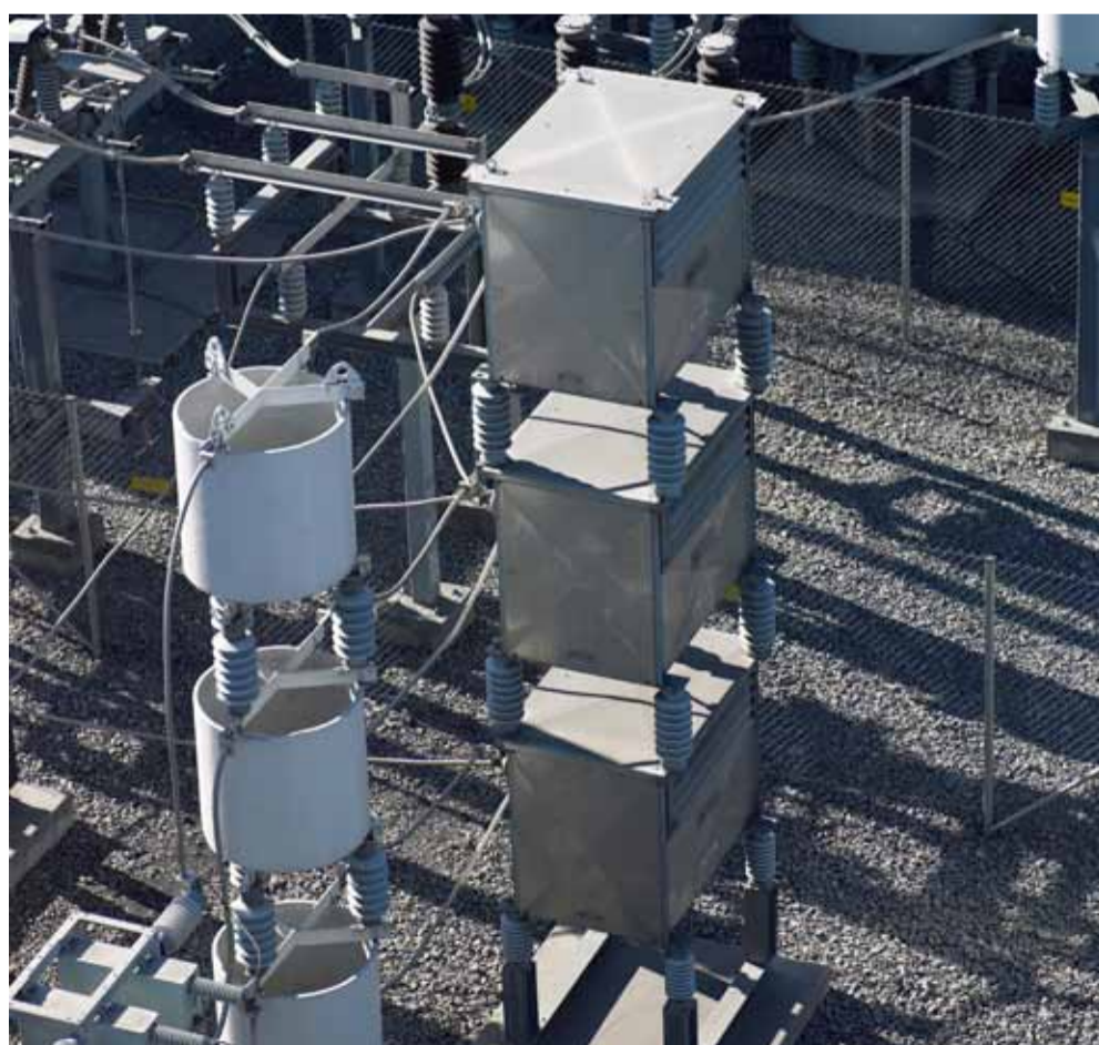
Bobines de réactance et résistances d'amortissement d'une installation SVC Light.
