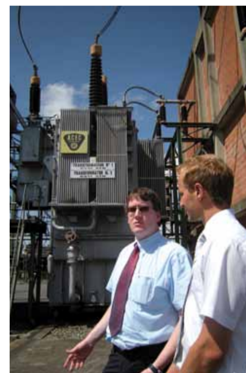
Messieurs Paul Leemans d'Elia (à gauche) et Daniel Krümmling d'ABB à côté d'un des transformateurs d'Elia
