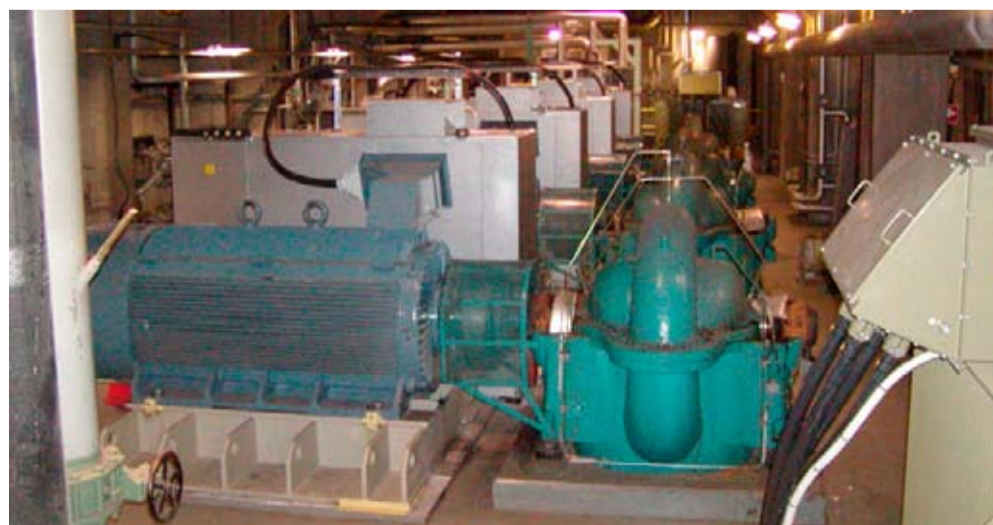
Eén van de zeven ACS 1000 regelbare aandrijvingen bij Mälarenergi
