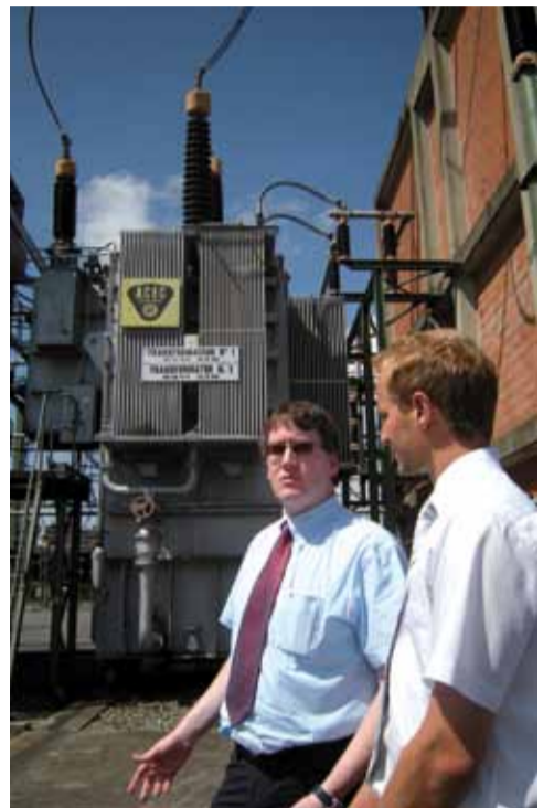
De heren Paul Leemans van Elia (links) en Daniel Krümming van ABB bij een van de transformatoren van Elia.
