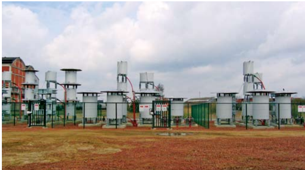
Links en rechts de filterweerstanden, in het midden de condensatorbank, daarachter de filterspoelen en vooraan meettransformatoren.
