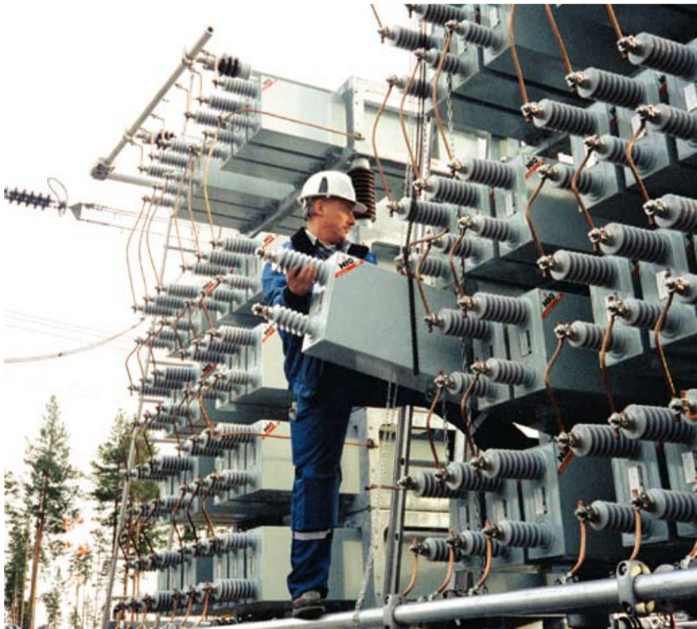
Naast onderhoud aan laagspanningsinstallaties heeft ABB ook jarenlange expertise op het gebied van doelmatige service aan midden- en hoogspanningsinstallaties.
