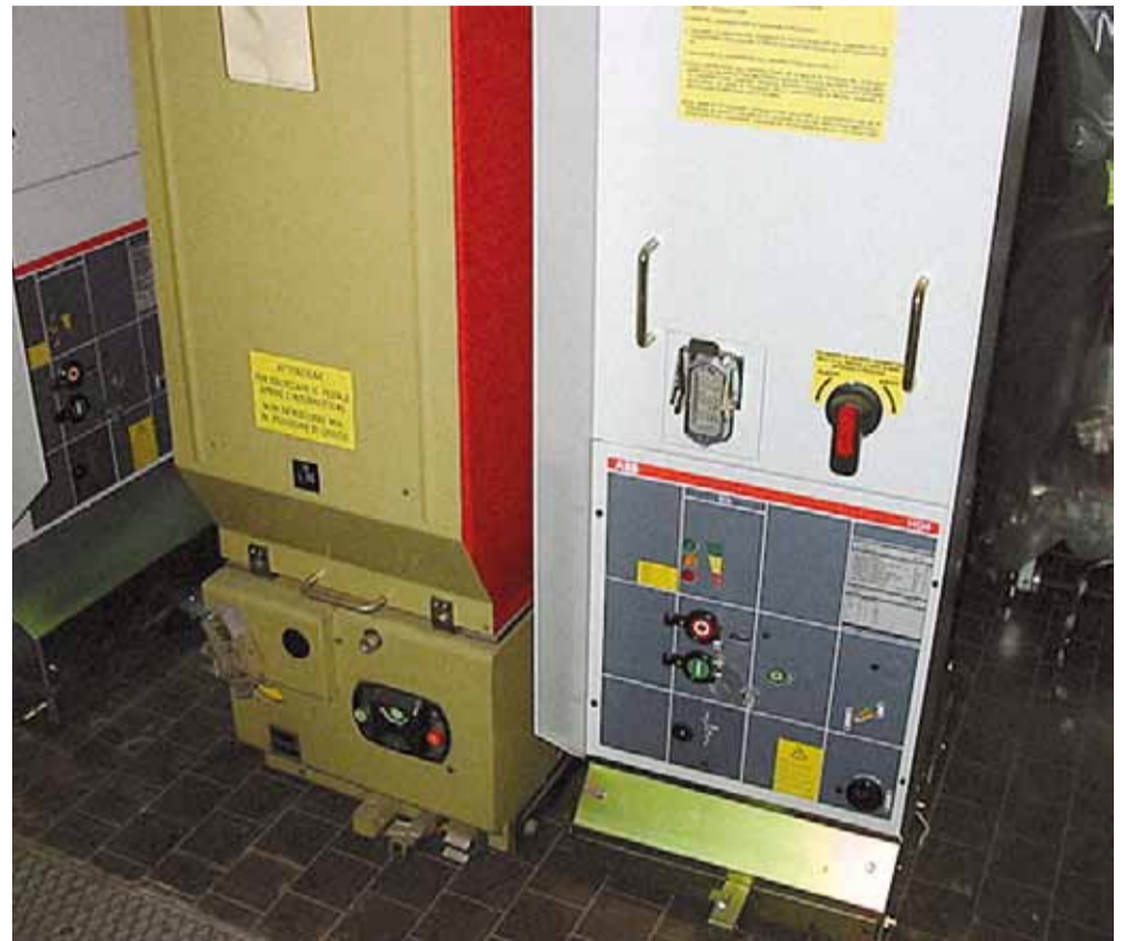
HD4 schakelaar van ABB als passende vervanger voor een oude Diarc-schakelaar.
