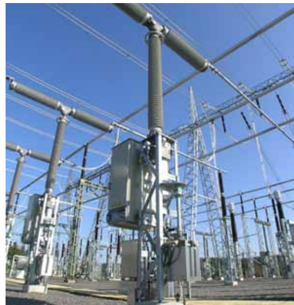
Interruptor Seccionador DCB.
