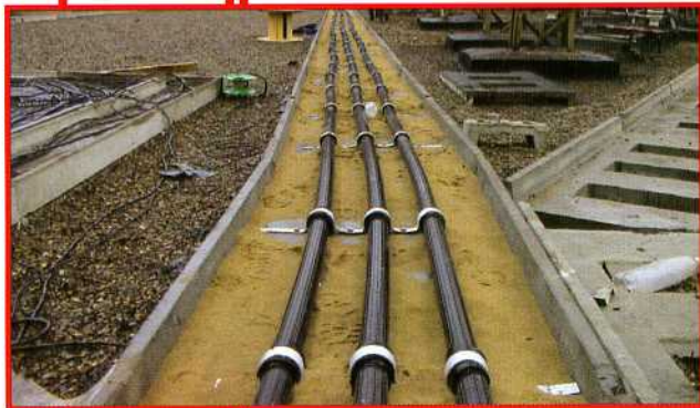
Кабельная линия 110 кВ, Энергетический комплекс АО "Казцинк", г. Усть- Каменогорск, Казахстан
