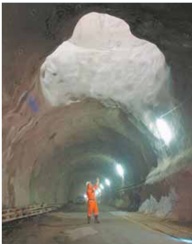
Вентиляционный туннель в Седране. ©AlpTransit Gotthard Ltd.
