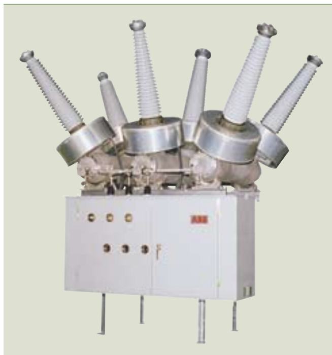
1 Типовой баковый выключатель на напряжение 145 кВ
