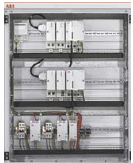
4 Контроллер AC 800M, смонтированный в стандартном шкафу.
