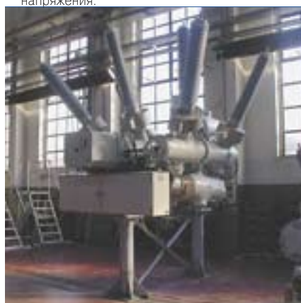
2 Модуль PASS M0 SBB с трансформаторами напряжения.
