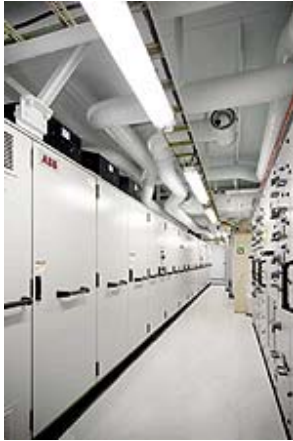
※ABBのACS 6000可変速ドライブがAzipod推進モーターを制御し、エネルギー効率を高めています。
