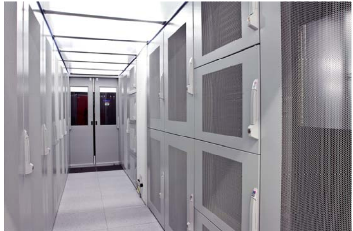
Heute verbrauchen Rechenzentren pro Jahr 80 Millionen Megawatt-Stunden Strom - womit sie den Energieverbrauch ganz New Yorks nahezu um das anderthalbfache übertreffen. Bild des green.ch Rechenzentrums, für welches ABB Schweiz ein erweitertes Gleichstrom-Energieverteilungssystem entwickelt und installiert.
